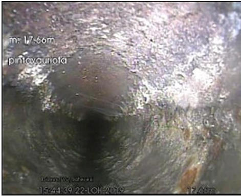
150 mm BET, vähäinen pintavaurio, klo 0–12
