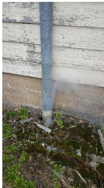
Tonttviemäriin puhallettu savu purkautuu rakennuksen kattovesien syöksytorven saumasta.
