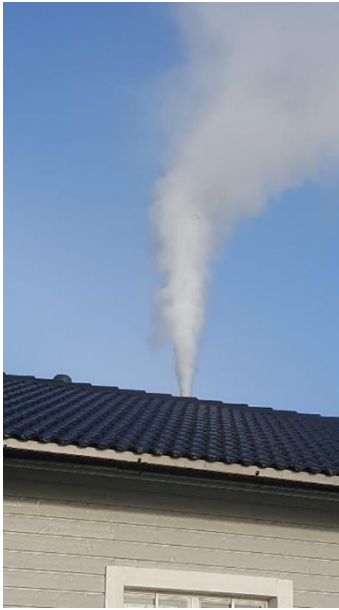
Tonttviemäriin puhallettu savu purkautuu tuuletusviemäristä katolle.
