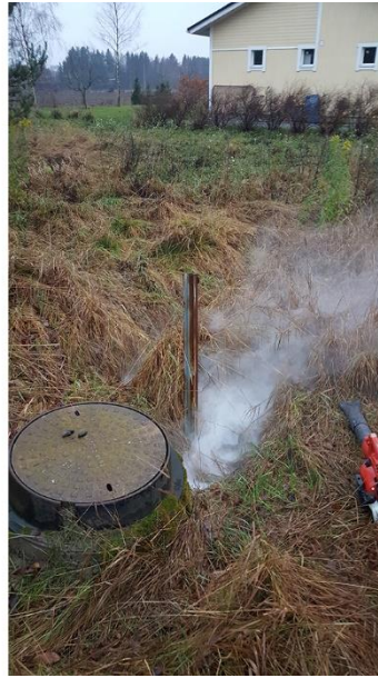
Runkoviemäriin puhallettu savu purkautuu tarkastuskaivon avoimista saumoista.
