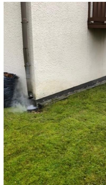
Tonttviemäriin puhallettu savu purkautuu kattove-sisuppilosta.
