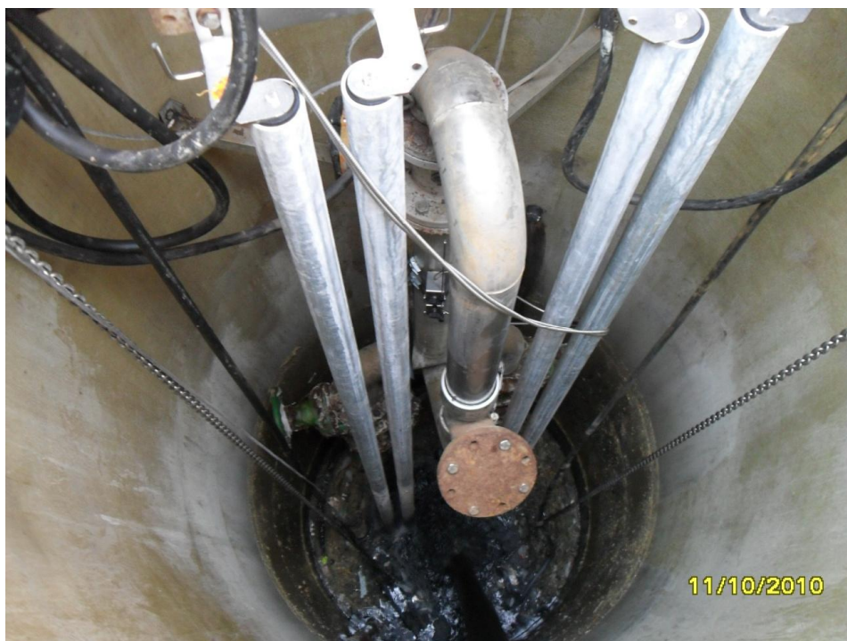
Kuva 20. Virtausmittaus Murron pumppaamolla.
