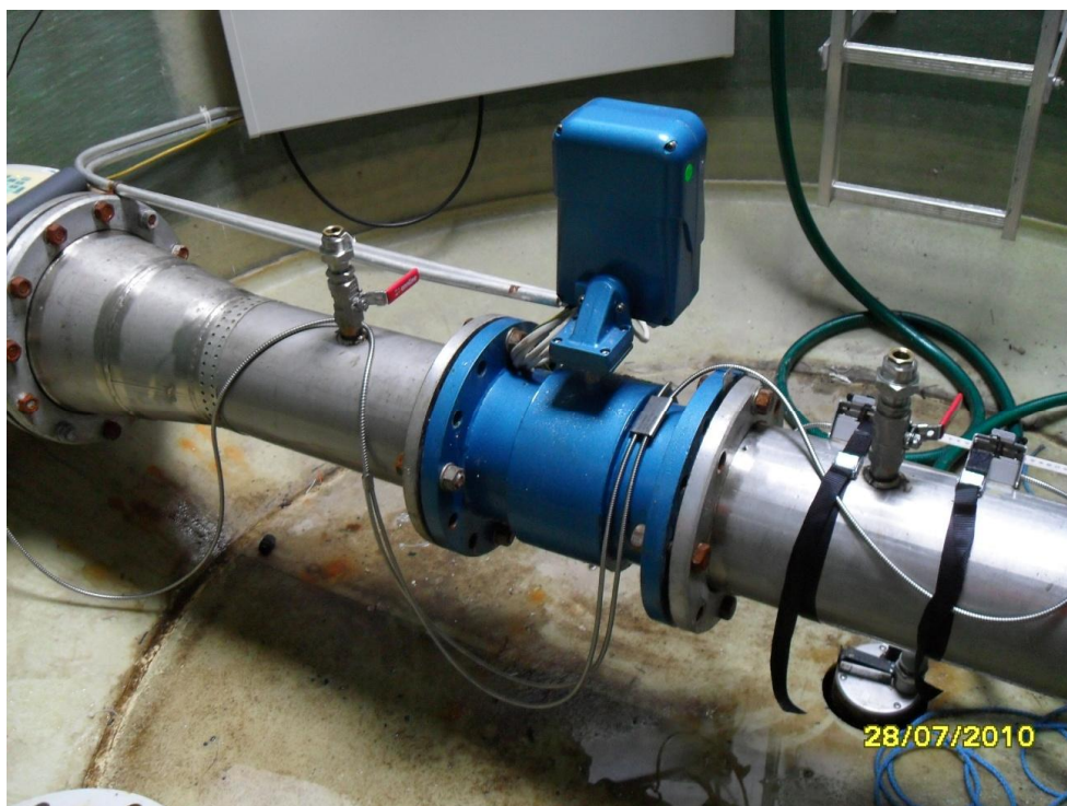
Kuva 5. Kiimingin mittauskaivossa Fluxus-mittari asennettuna.
