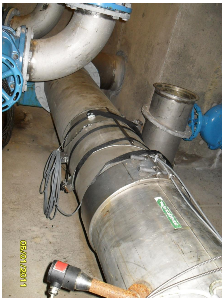
Kuva 31. Ervastinrannan puhdistamolle Simppulan pumppaamolta tulevan jätevesimäärän mittaust.
