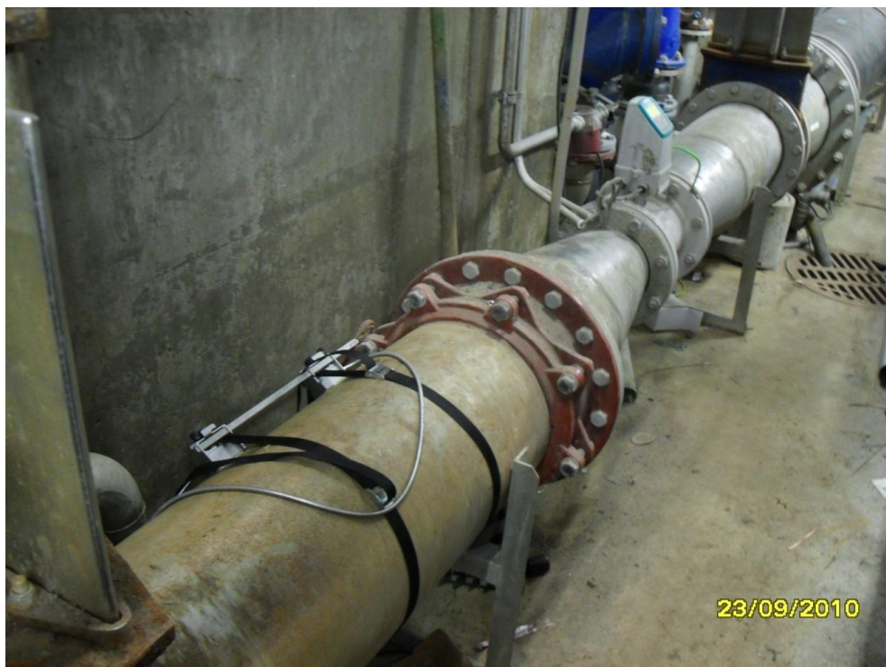
Kuva 27. Lakeuden Keskuspuhdistamolta lähtevän veden mittaus.
